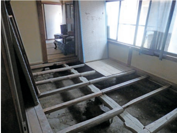
床上浸水／玖珂西組 法性寺
